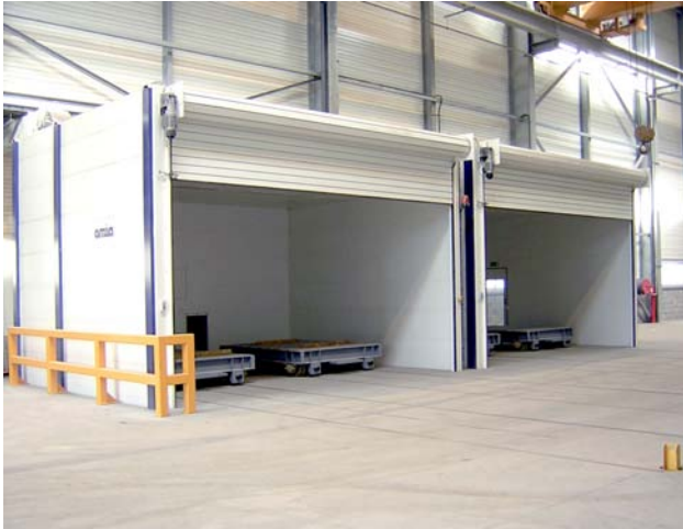
Séchage peinture pièces de fonderie Paint drying of foundry parts
