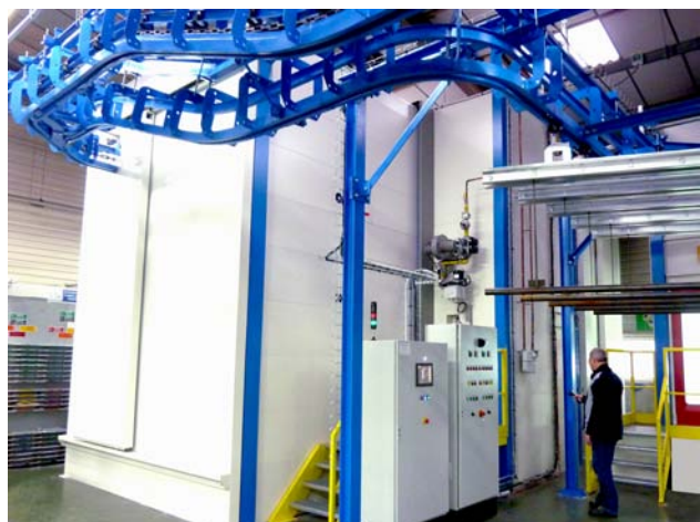
Polymérisation poudre - portes blindées Powder polymerization - armored doors
