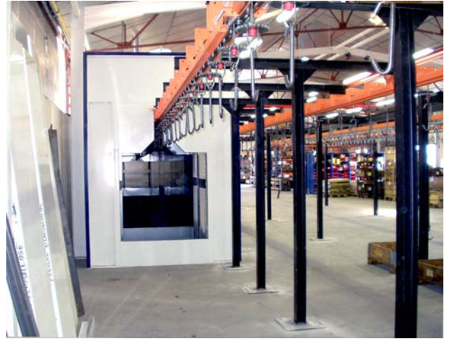
Séchage peinture solvantée ferroviaire Railway parts solvent paint drying
